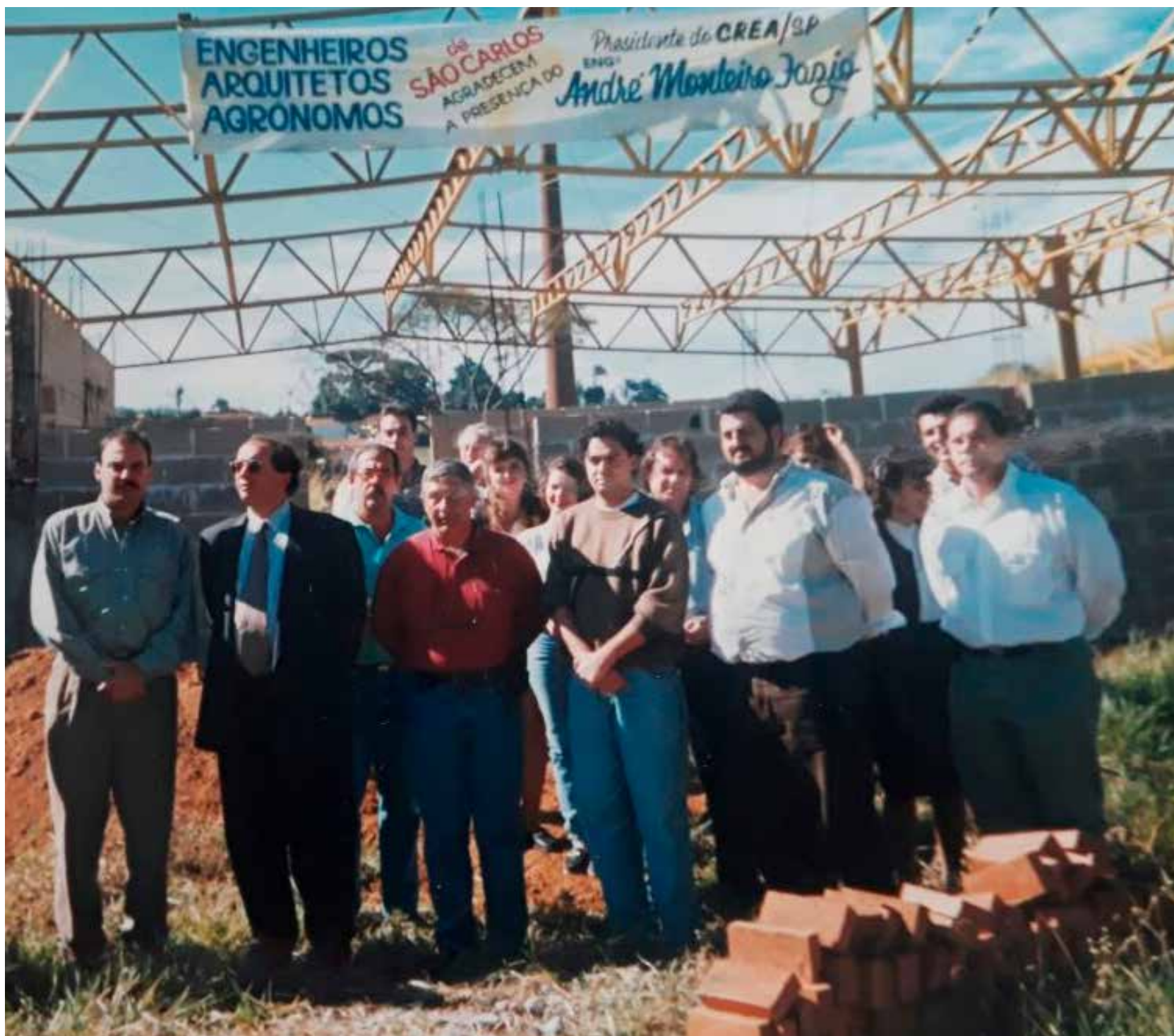
Visita às obras da Inspetoria Regional de São Carlos e sede da AEASC com a presença do presidente do CREA-SP André Monteiro Fazio
